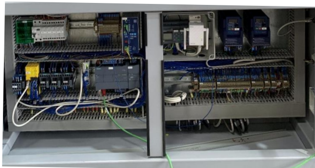
Vue de l'armoire électrique
