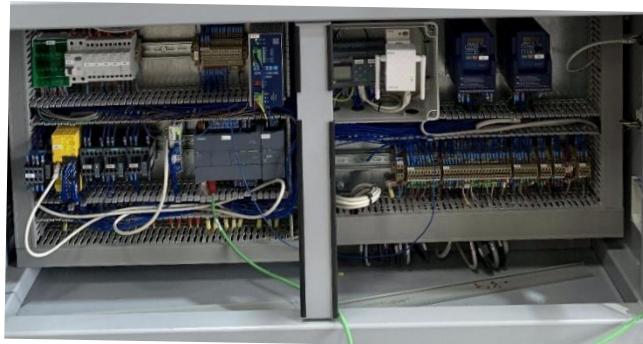
Vue de l'armoire électrique
