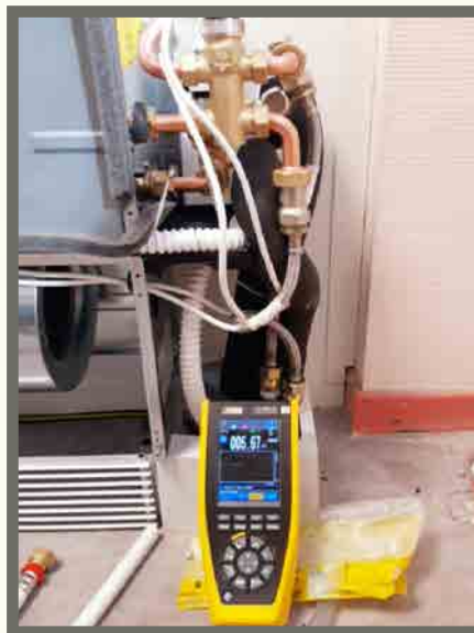
Mesure sur système de chauffage et climatisation : courant, tension, température.
