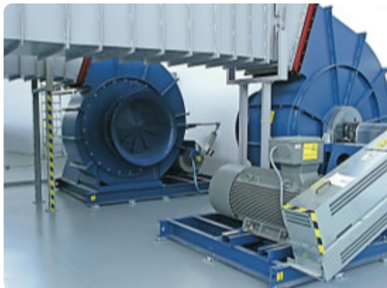
Le balourd est critique dans les installations a ventilateurs (transmission directe ou poulie courroie)
